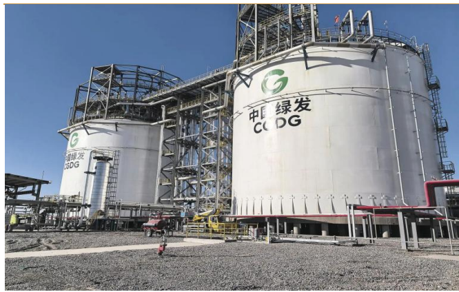
图 23：公司参与青海省液态空气储能示范项目
