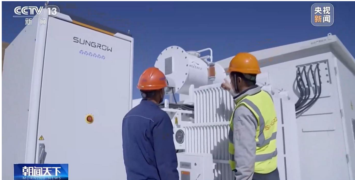
图 39：华电西藏才朋光储电站二期采用阳光电源构网型储能技术
