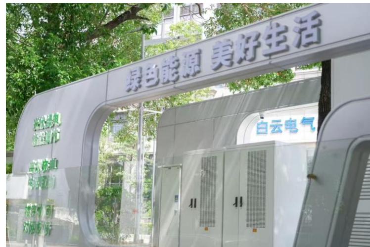
图：为光能源的SST项目
