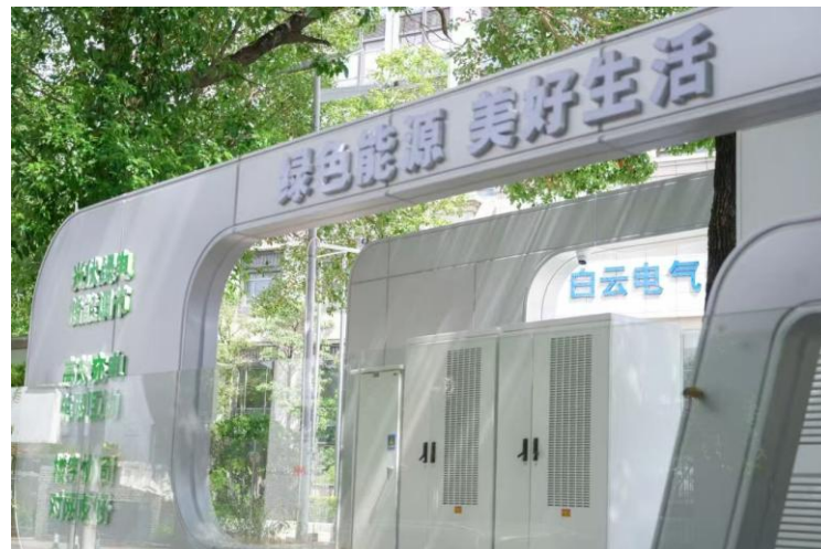
图：为光能源的SST项目
