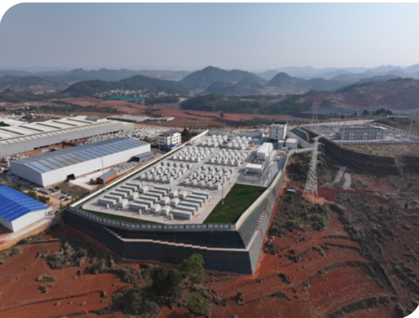
宝池锂钠混合储能电站
