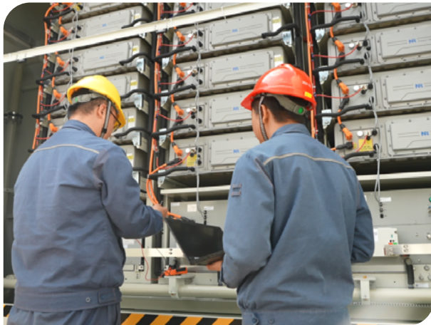
工作人员定期检查电站情况
