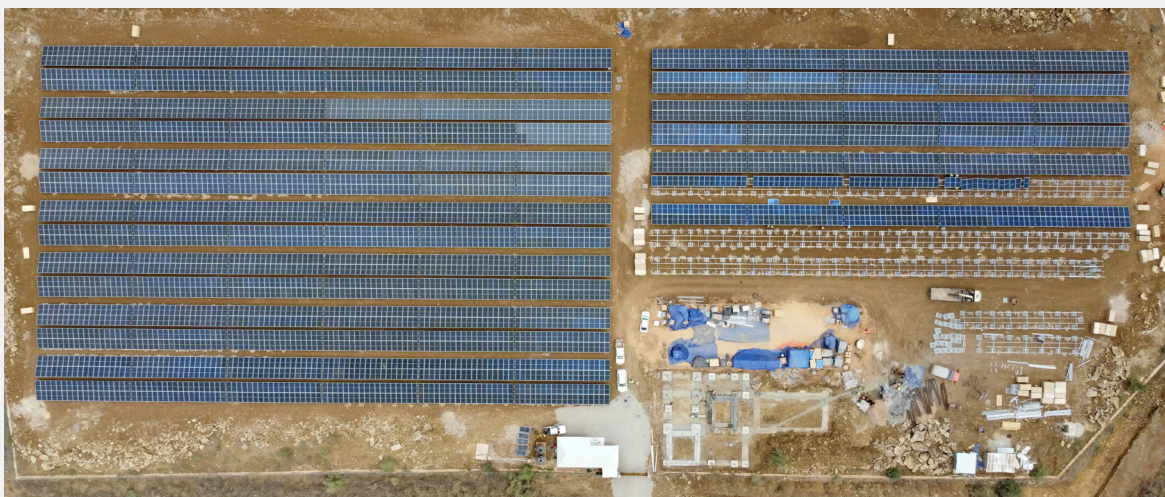
图5 白豆太阳能项目建设阶段
