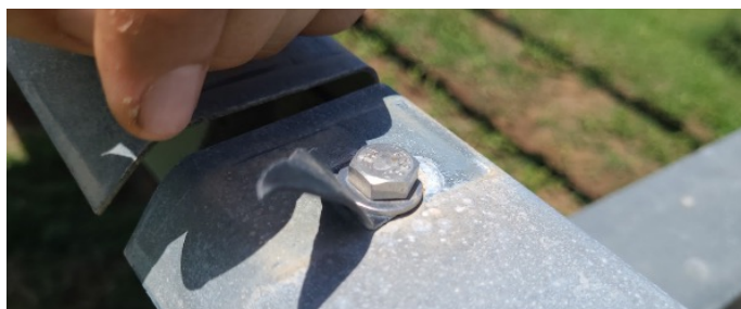
太阳能电池板框架孔撕裂。照片由Chris Needham，AAS提供
