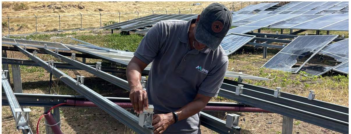
菲德尔·内文森，RMI，正在调查圭亚那岛上的故障T型槽支架和自上而下夹具。照片由Skylar Bee，RMI提供
