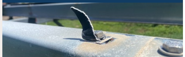
太阳能电池板框架孔撕裂，梅勒，七月2024。照片由克里斯·尼德汉姆，AAS提供
