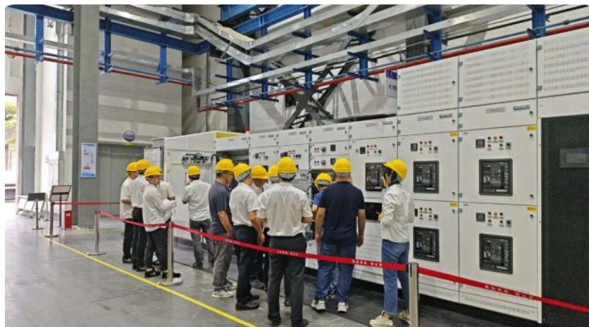
图：字节跳动火山引擎数据中心项目
