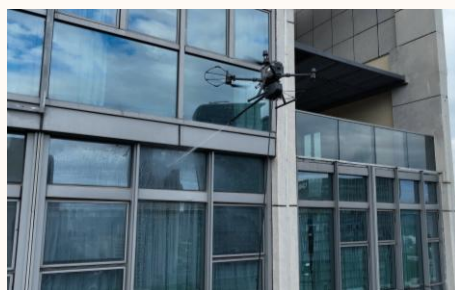
AP3-P3 为深圳某办公楼清洗
