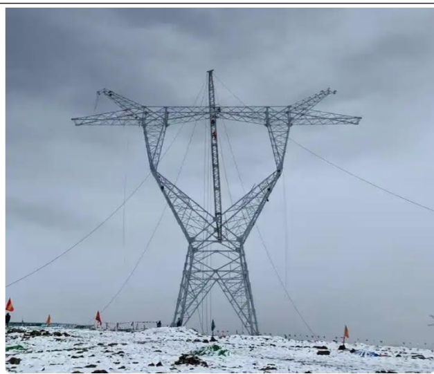
图 16：世界上海拔最高的特高压输电铁塔
