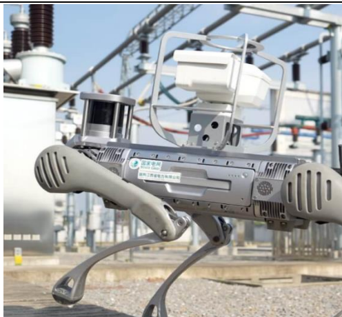
图16：宇树机器狗在变电站巡检
