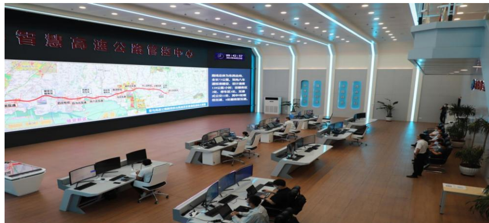
雄安交投 荣乌高速新线智慧高速管控中心
