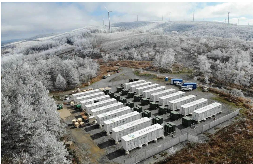
图表 国轩高科美国72MW/72MWh储能调频项目
