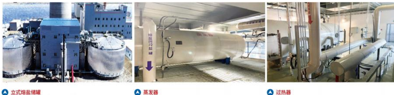
图 63：公司熔盐储能技术应用
