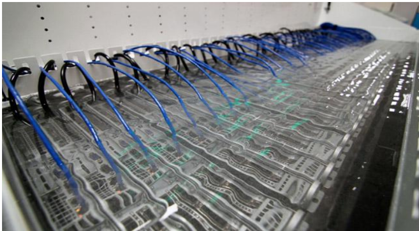
图：数据中心浸没式液冷系统
