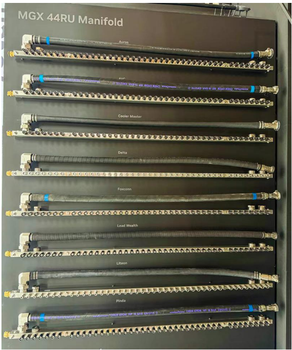
图：英伟达液冷Manifold主要供应商展示
