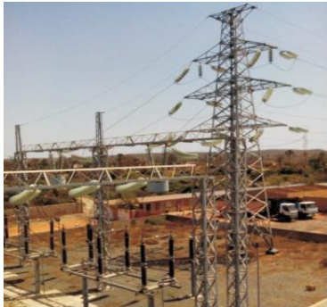
塞内加尔SOMETA公司90kV/10kV变电站项目
