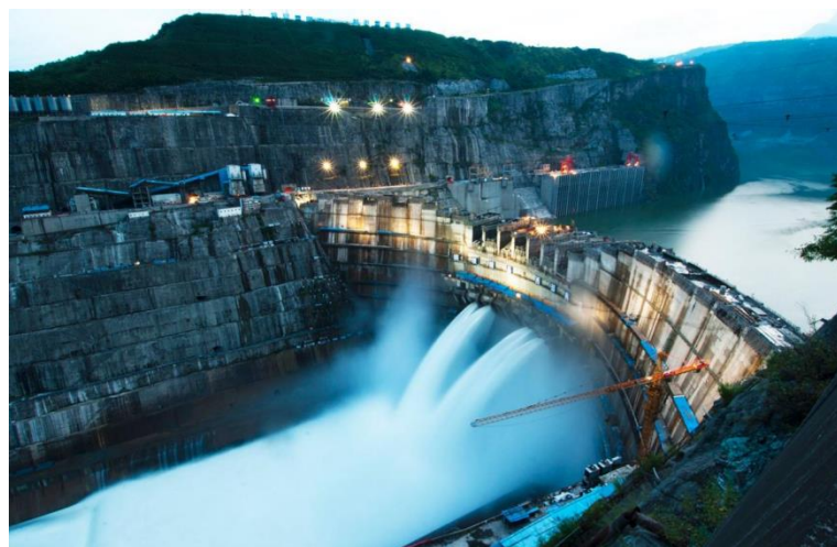
图 11：溪洛渡水电站
