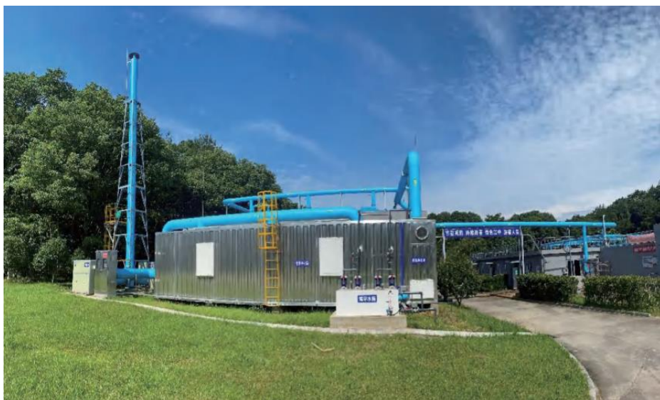
污水处理站废气加盖除臭装置
