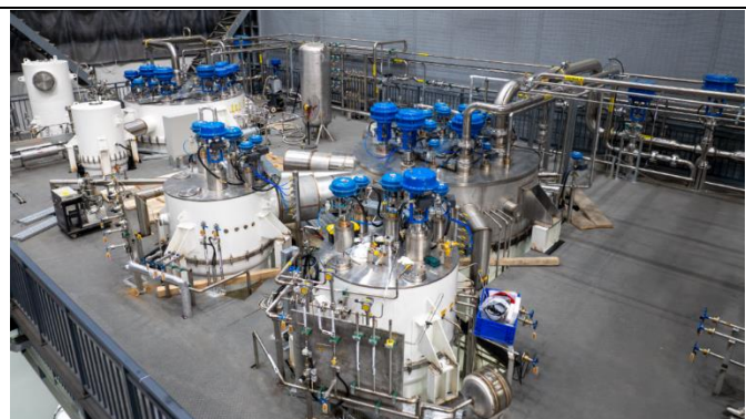
图6：中科清能 3kW@4.5K 氦制冷机氦制冷机在合肥一次启机成功
